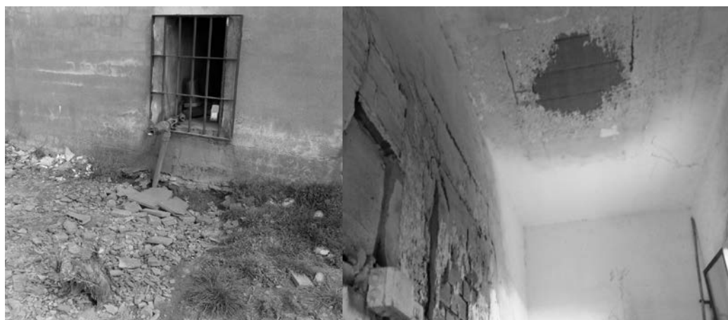
Figura 12. Efectos de la salida de agua y gas en el exterior e interior de la caseta de un sondeo.
