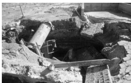
Figura 5. Situación del sondeo tras el hundimiento y cese de la salida de gas y agua.
